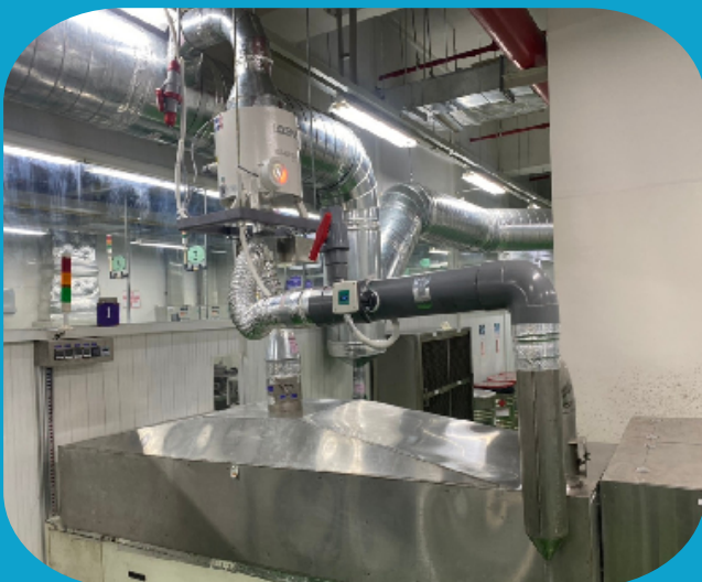
Hệ thống hút hơi dầu
